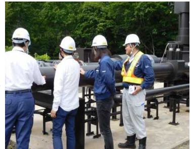
還元基地。熱水は、熱水ピットから約2.4キロメートルもある輸送管を通り、この還元基地で地下深くへと戻されます。
