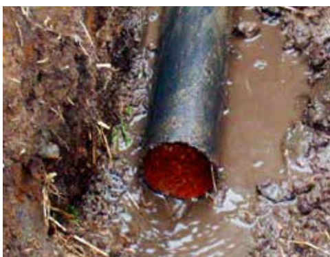
暗渠管内の鉄の集積
