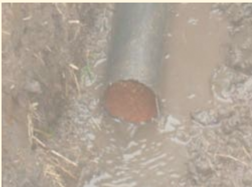
詰まった暗渠管も
