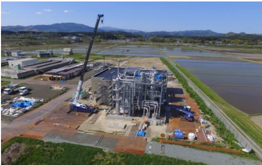
県北地区広域汚泥資源化施設 外観
