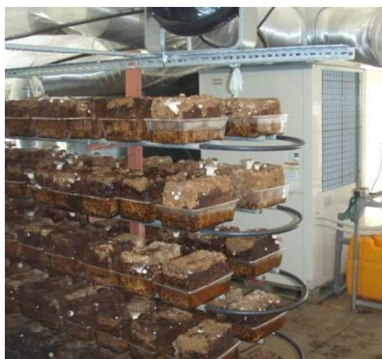
【地下水熱ヒートポンプエアコン】
