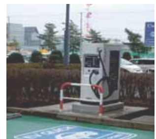
急速充電器（県庁第二庁舎）
