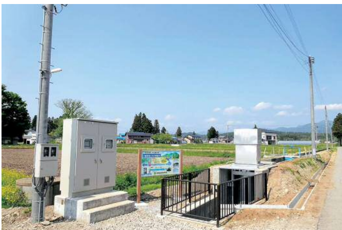
小水力発電設備 六郷東根地区（美郷町）
