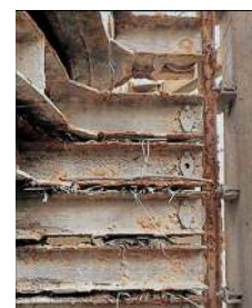
シリンダーゲート腐食状況
