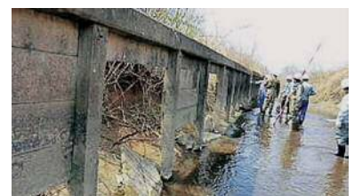
腐食が進行している幹線用水路
