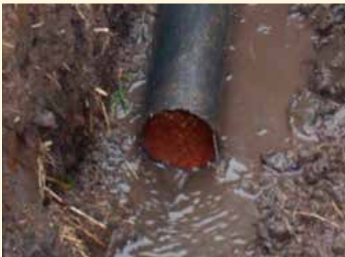
詰まった暗渠管も
