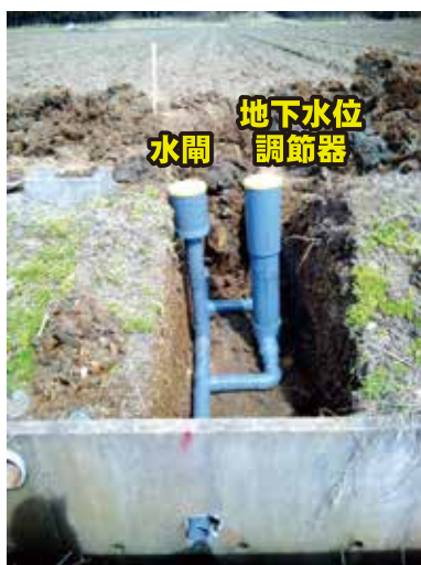
下流側の水位調節器
