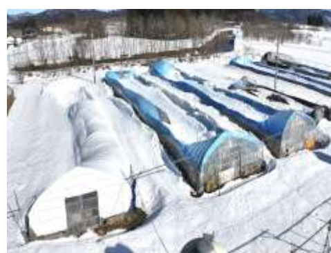
（雪害）大館市 比内地鶏鶏舎の倒壊
