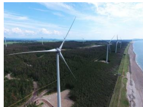
風の松原風力発電所(能代市)
