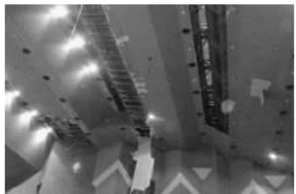
文化施設大ホール：天井脱落、下地変形
