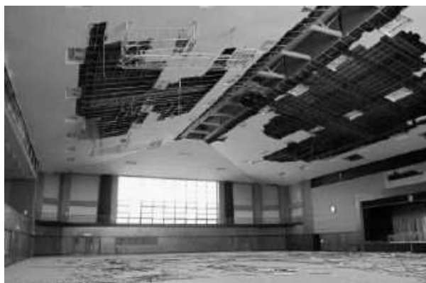
体育館：天井脱落、下地破損
