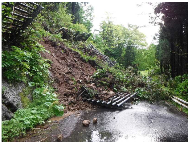
【崩落した県道 十文字羽後鳥海線（由利本荘市）】
