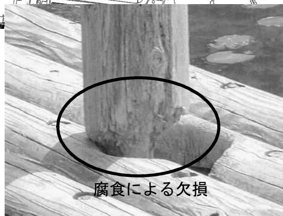
遊具木材腐食状況
