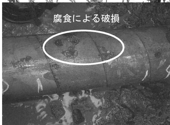
給水管腐食状況
