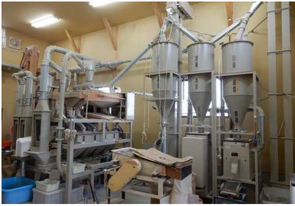
【施設内の製粉ライン】
