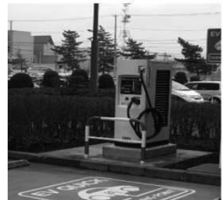
急速充電器（県庁第二庁舎）
