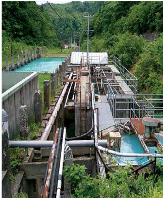
吉乃鉱山（横手市）坑廃水処理施設
