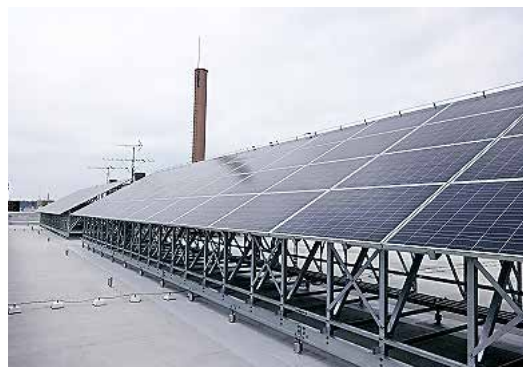
県庁舎に設置した太陽光発電設備
