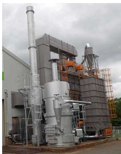
(プレカット工場) 集塵機、焼却炉
