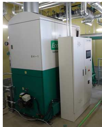
【木質バイオマスボイラー】
