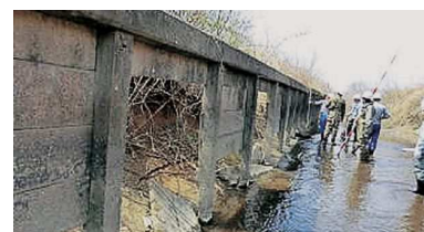
腐食が進行している幹線用水路
