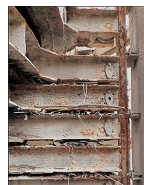
シリンダーゲート腐食状況
