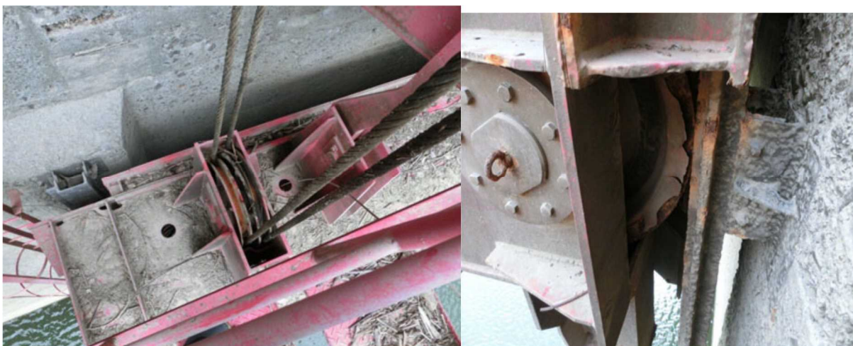
写 3-4-(2) 機械設備損傷例
