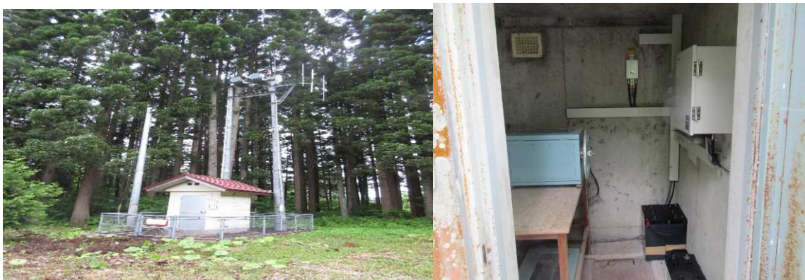
写 3-6-(2) 電気通信設備損傷例
