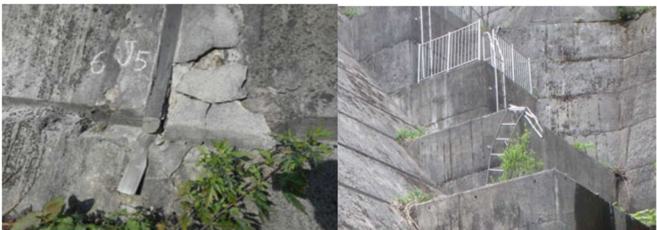
写 3-2-(2) 土木施設損傷例
