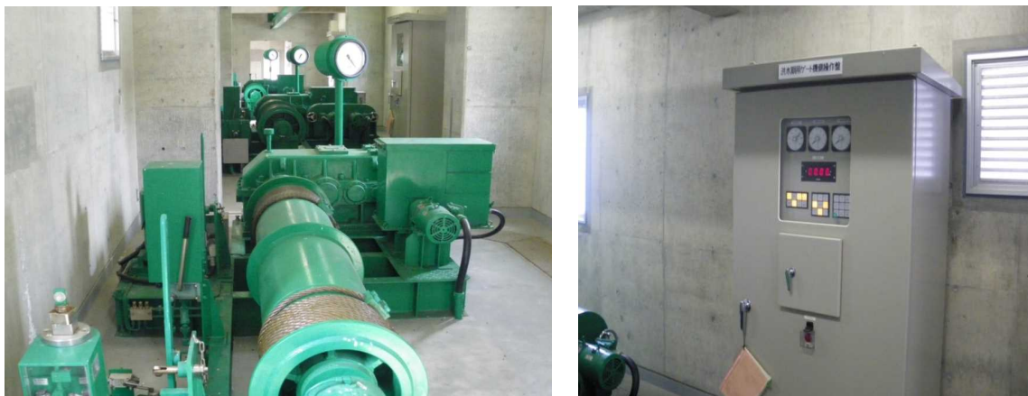
写 2-1-(2) 機械設備の例
