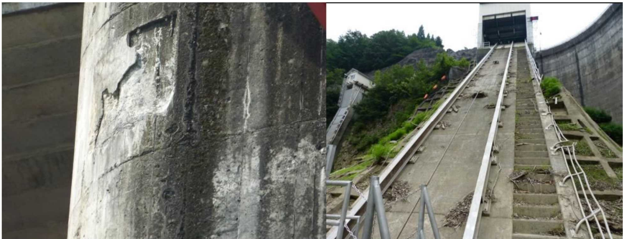
写 3-2-(1) 土木施設損傷例
