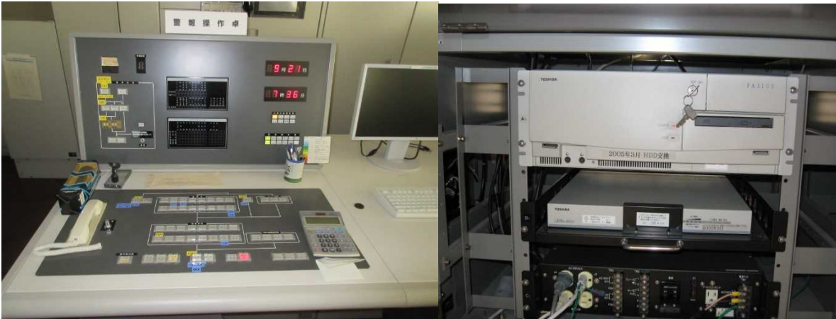
写 2-1-(2) 機械設備の例
