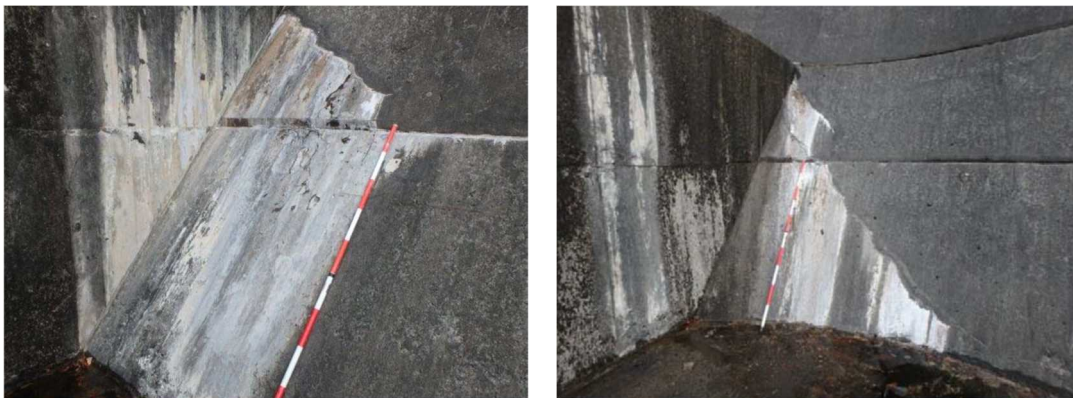
写 3-2-(1) 土木施設損傷例
