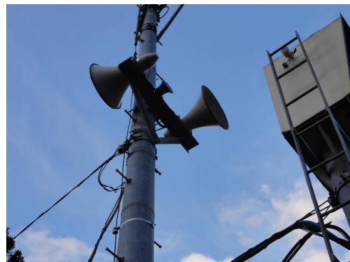
写 3-6-(2) 電気通信設備損傷例
