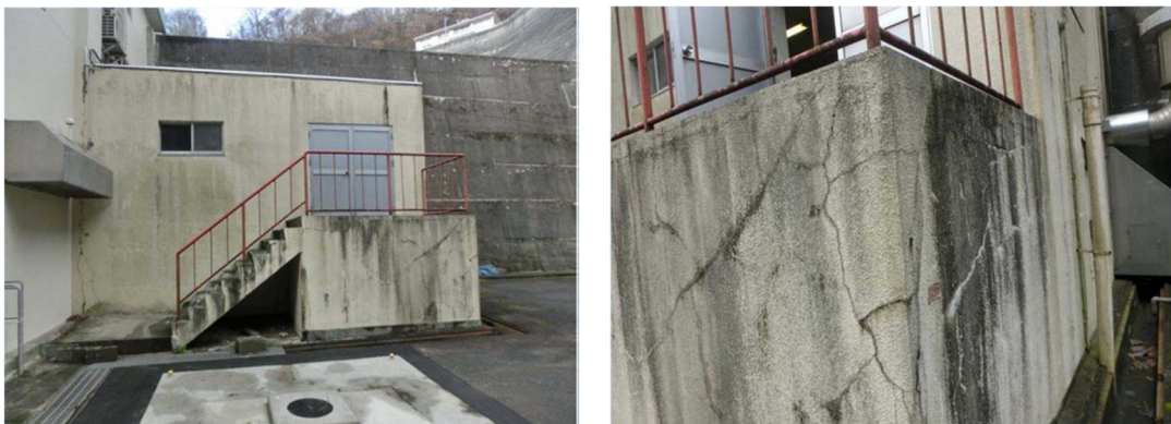
写 3-2-(2) 土木施設損傷例
