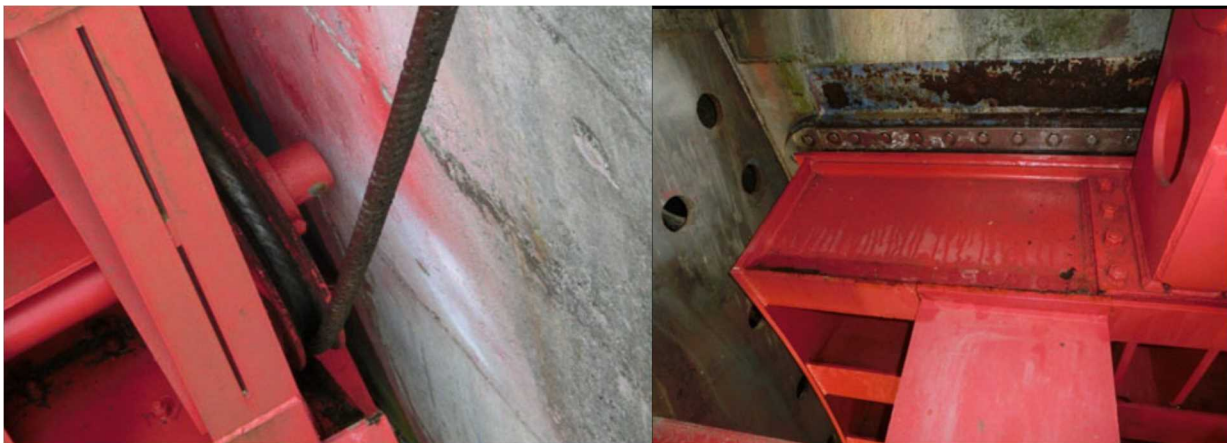
写 3-4-(1) 機械設備損傷例
