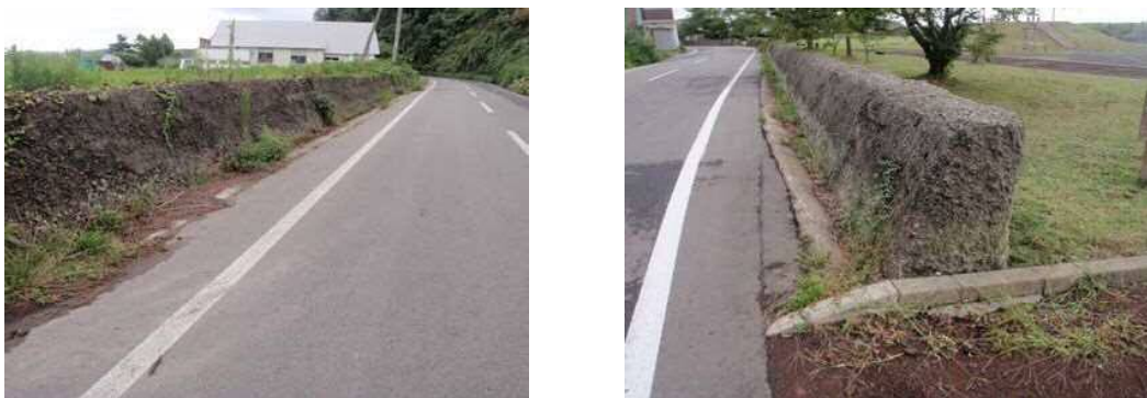
写真－ 1.1 ②-1 北浦護岸 現況写真 (平成 28 年 9 月撮影)
