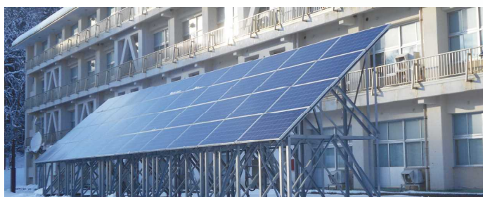
▲太陽光発電（小坂町役場駐車場）
