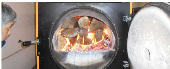
▲木質バイオマスボイラー（道の駅十和田湖）
