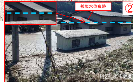
浸水解消後の流入土砂堆積状況
