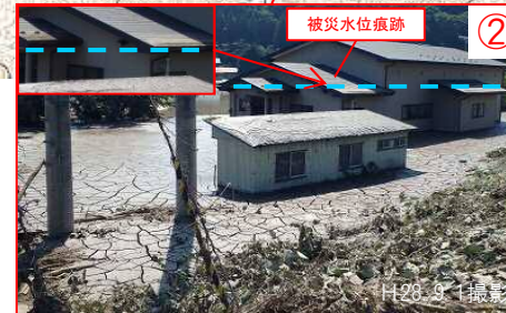
浸水解消後の流入土砂堆積状況
