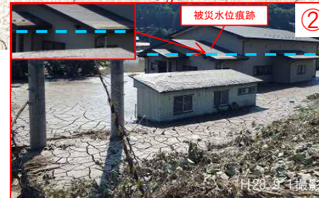
浸水解消後の流入土砂堆積状況
