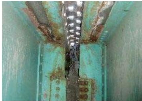
解説 写 8.1.1 伸縮装置止水材の脱落事例
