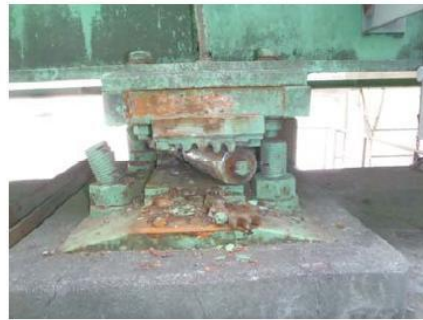
解説 写 8.2.2 地震によるローラー支承の損傷
