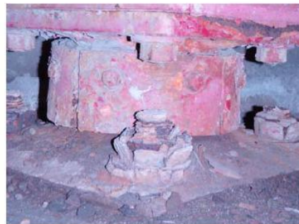
解説 写 8.2.4 アンカーボルトの著しい腐食
