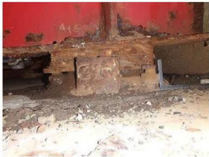
解説 写 8.2.1 支承の著しい腐食
