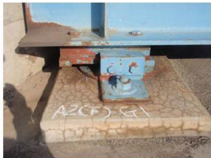
解説 写 8.2.3 支承の遊間異常
