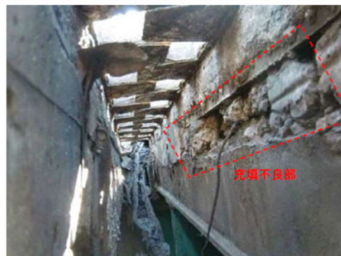
解説 写 8.1.2 後打ちコンクリートの 充填不良事例
