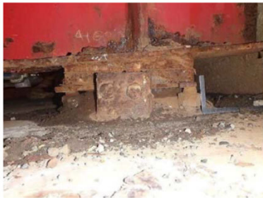
解説 写 8.2.1 支承の著しい腐食
