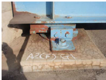
解説 写 8.2.3 支承の遊間異常
