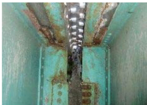
解説 写 8.1.1 伸縮装置止水材の脱落事例
