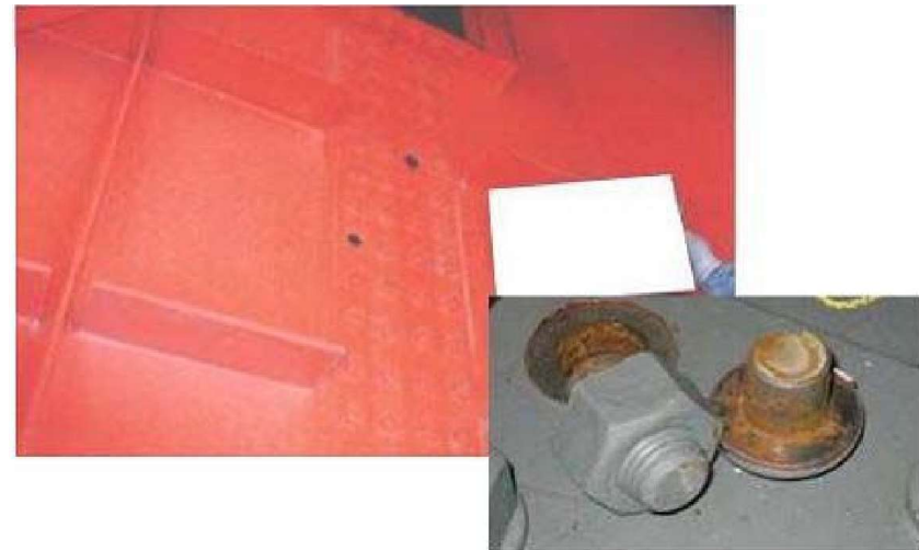
ボルトの脱落及び破断
