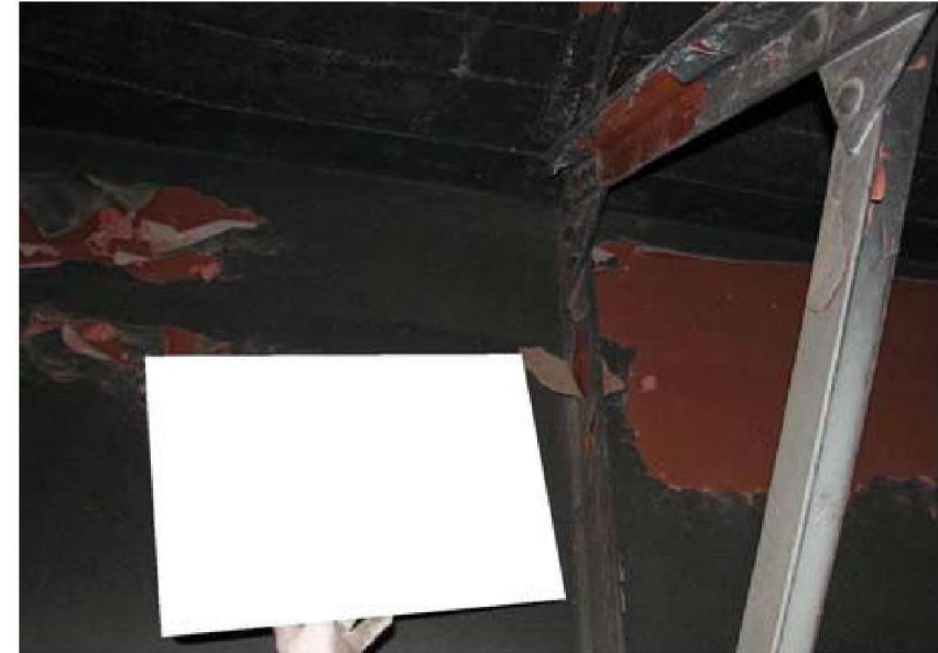
火災による主桁の変色・劣化
