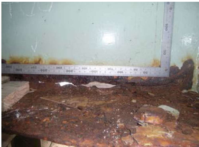
支点部付近の腐食・欠損
