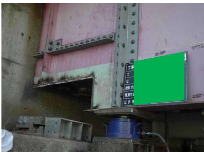
腐食部切断状況
