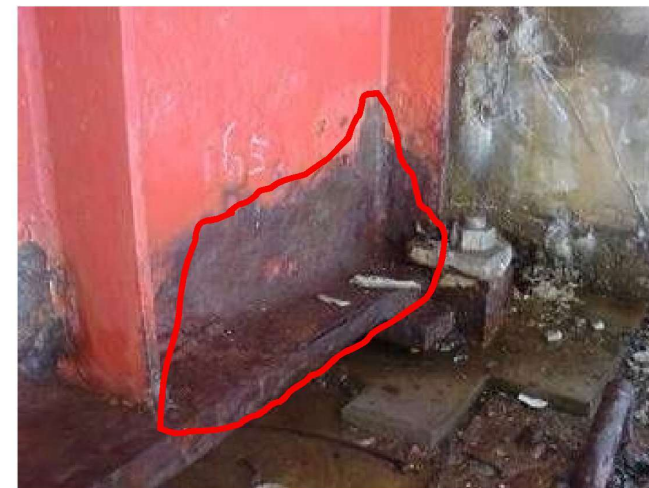
桁端部の腐食状況
