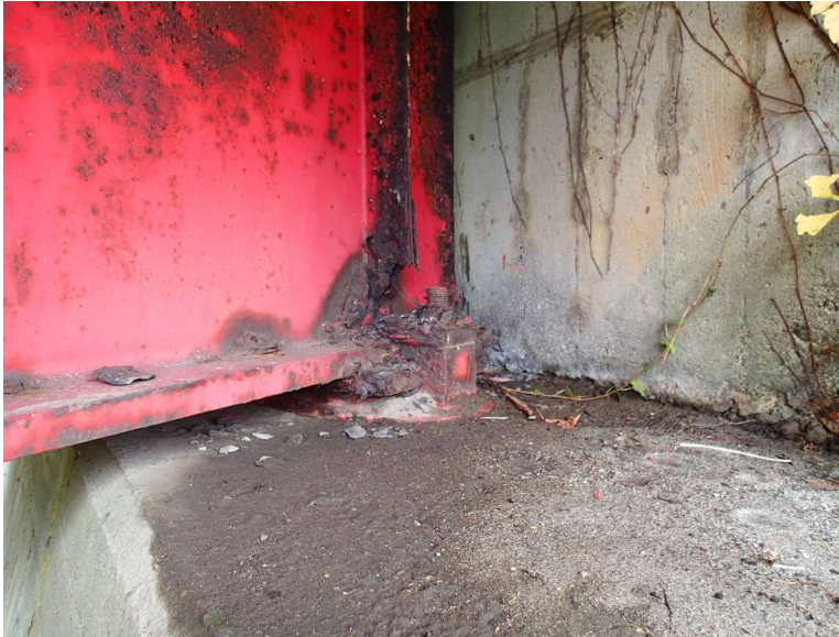
補修前（欠損・減厚）
