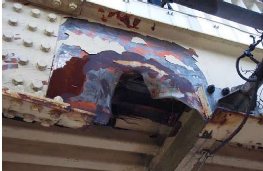
車両衝突による損傷
