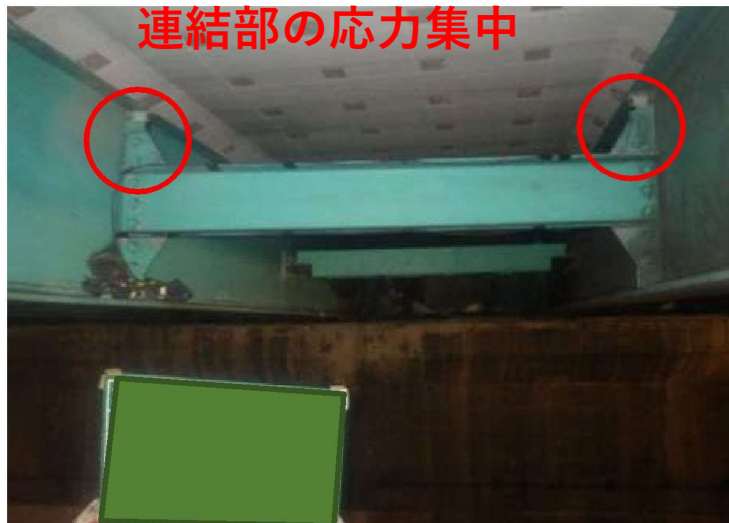
既設横桁（垂直補剛材の亀裂）
