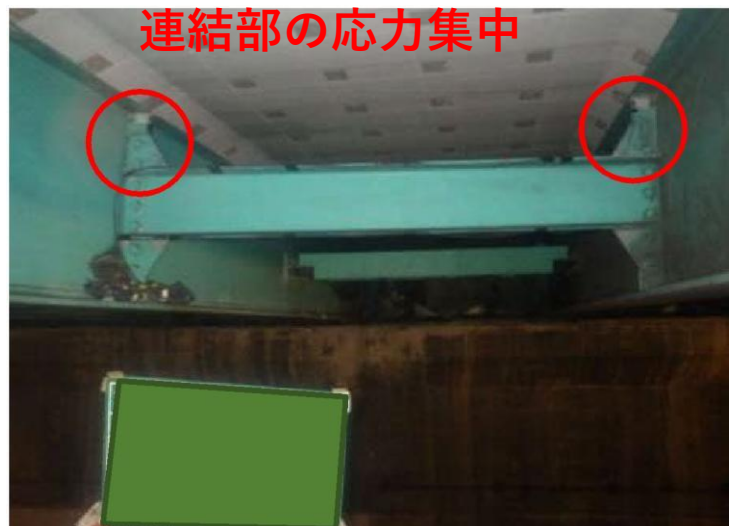
既設横桁（垂直補剛材の亀裂）
