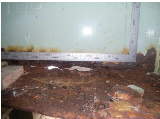
支点部付近の腐食・欠損
