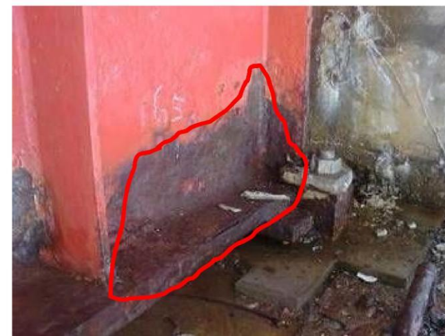
桁端部の腐食状況
