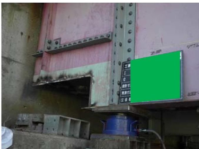
腐食部切断状況
