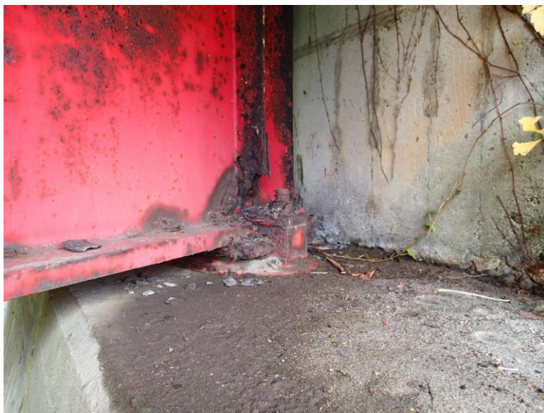
補修前（欠損・減厚）
