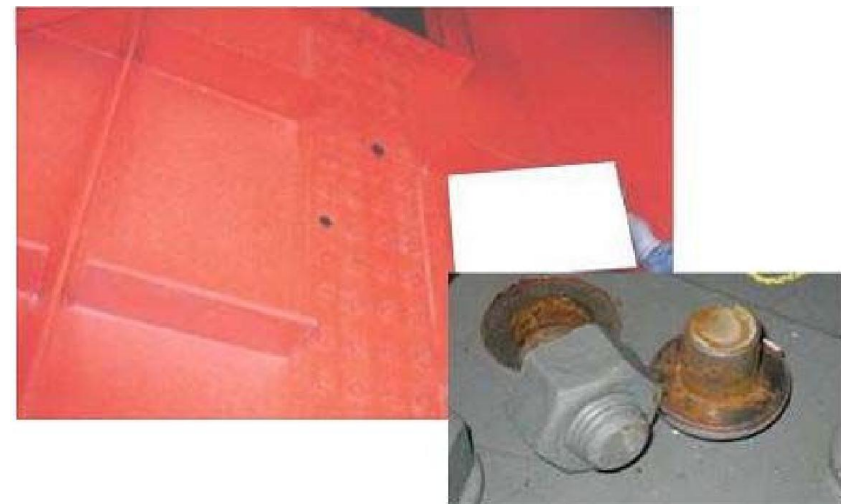
ボルトの脱落及び破断
