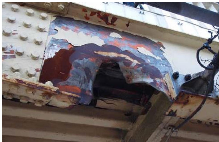
車両衝突による損傷
