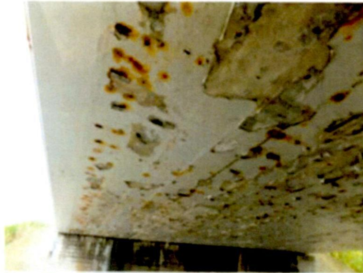
写真 18-1 錆汁と表面被覆材・断面修復材の剥離
