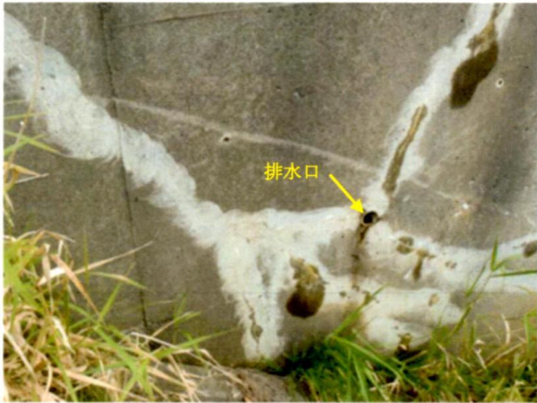
写真 21-1 水抜き孔近傍の漏水とエフロレッセンス析出の状況
