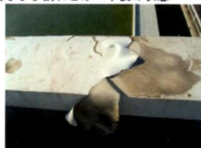
b) 塗装の剥がれ
