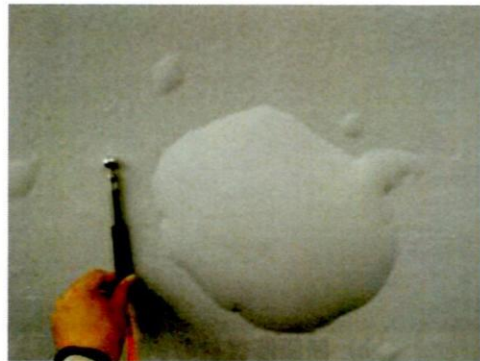
写真 11-1 下部構造における表面被覆材(中塗り)の大きな膨れ
