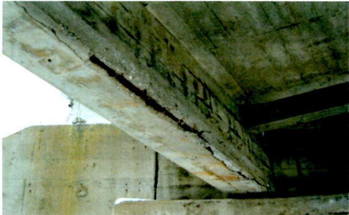
解説 写真-2.2.1 桁の下面における塩害による劣化事例
