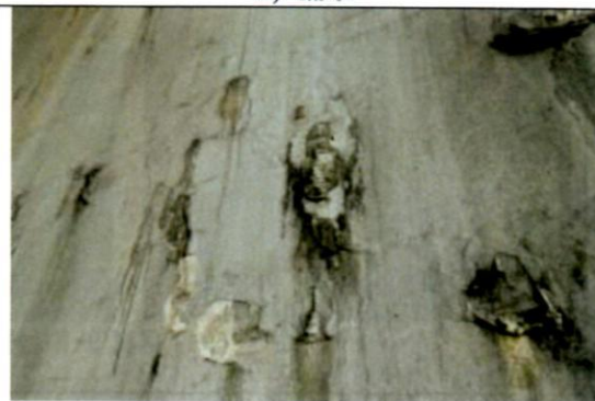
d) 割れ, 漏水
