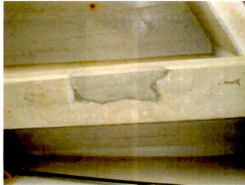
a) 断面修復材の剥落前
