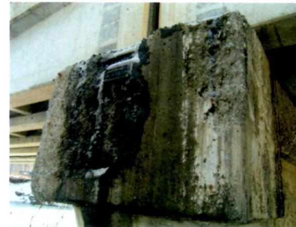
解説 写真-2.2.3 橋面排水が流下する箇所の凍害による劣化事例
