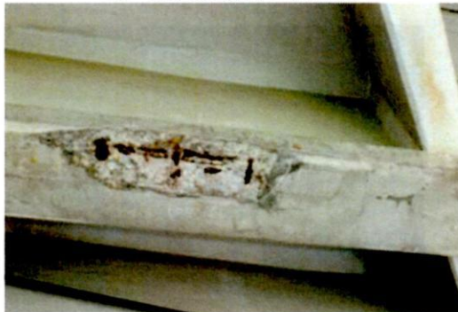
b) 断面修復材の剥落後 写真 12-1 断面修復部の剥落状況
