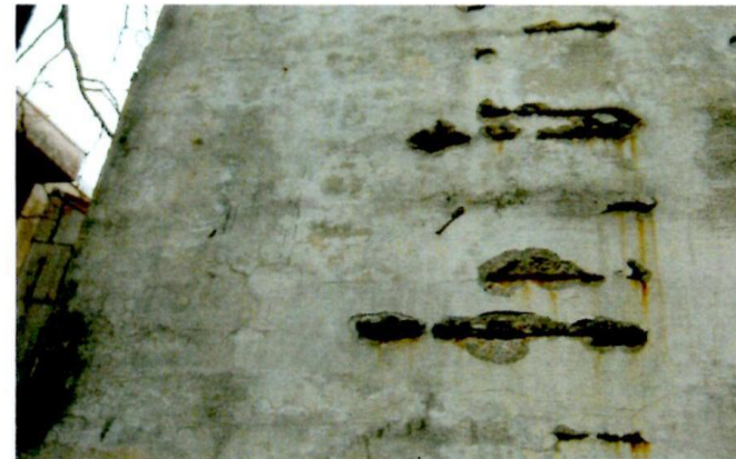
解説 写真-2.2.2 かぶりの薄い箇所における中性化による劣化事例
