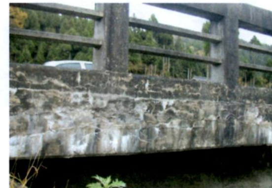
解説 写真-2.2.4 路面排水の影響を受ける箇所でのアルカリシリカ反応による劣化事例
