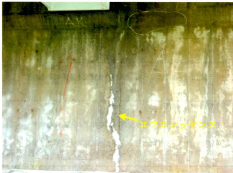
写真 22-1 ひび割れ充填工法の適用箇所とエフロレッセンス析出の状況
