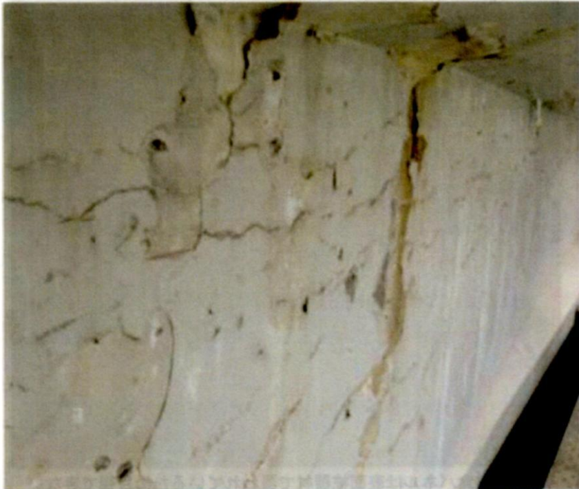
※流電陽極材は表面被覆材で覆われているため目視できない 写真 25-1 桁側面における表面被覆材のひび割れや剥がれ
