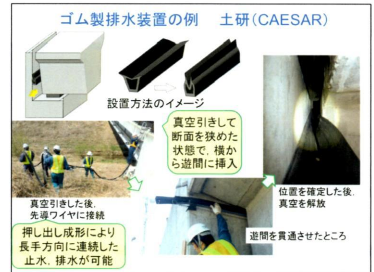
解説 図-2.3.3 橋梁の桁端における樋の設置 (資料提供: 土木研究所 CAESAR)
