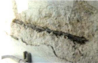
c) 浮きコンクリートを剥がしたところ、鉄筋腐食による浮きであったことを確認 (かぶり厚さは3~4cm)
