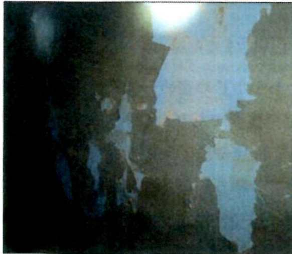
解説 図-3.2.1 気体の水分(水蒸気)の結露が要因となり発生した塗膜の剥離
