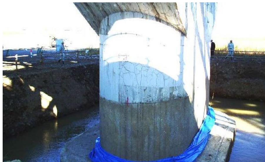
柱部の縦方向ひび割れが地中部まで連続している
