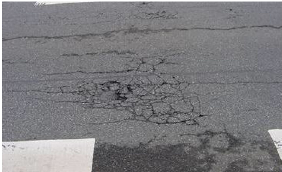
舗装のひび割れ
