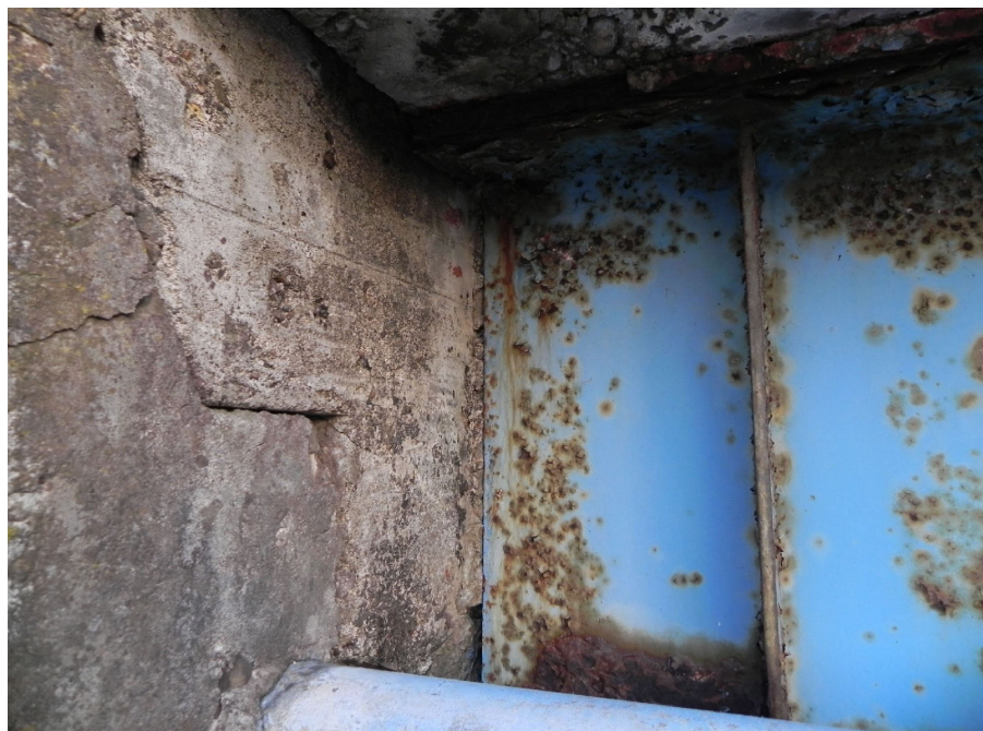
橋台と桁のぶつかり
