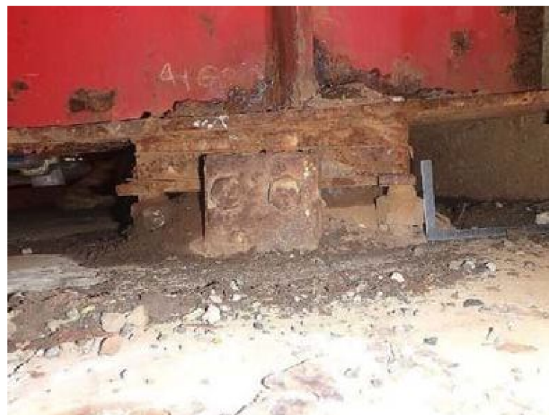
支承の著しい腐食
