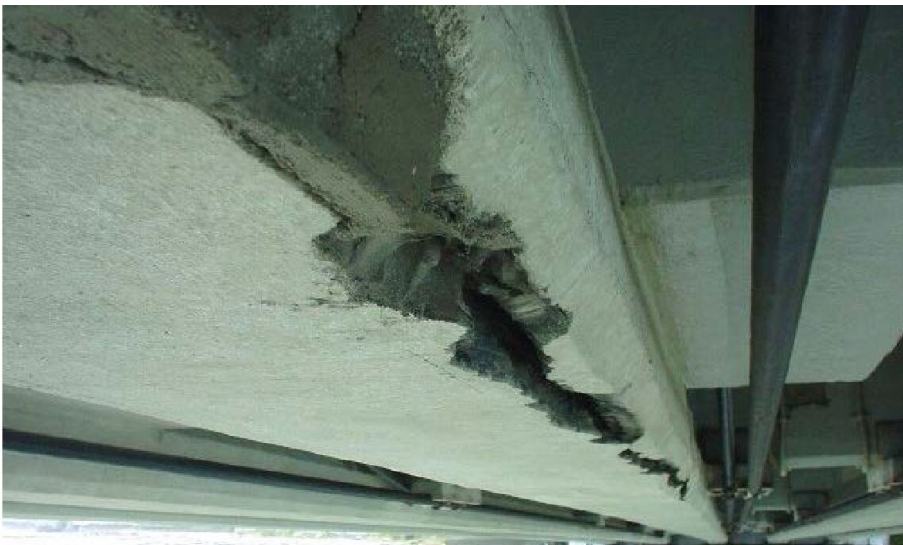
再劣化により、ひび割れ、鋼材露出
