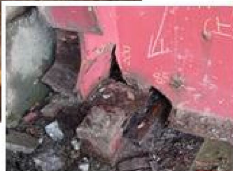
桁端部の腐食
