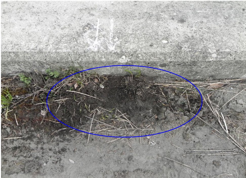
排水柵の土砂詰まり
