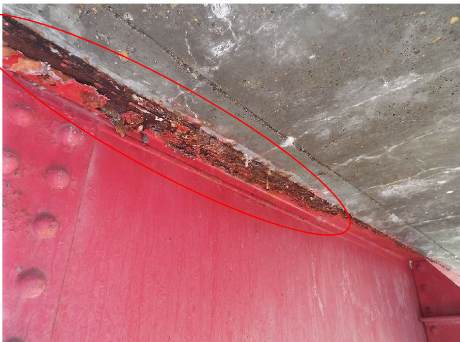
床版からの漏水による腐食
