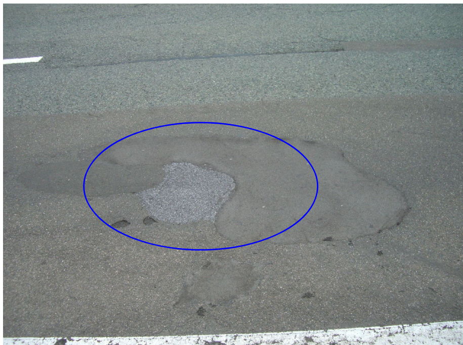
舗装にポットホール 凸凹がある
