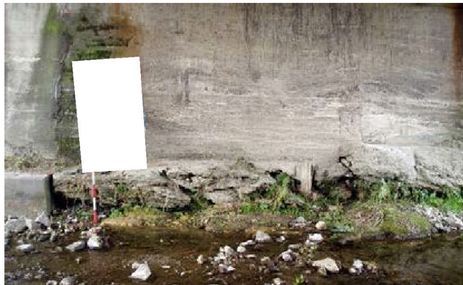
橋脚が洗堀されている
