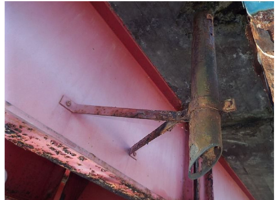
排水管の腐食
