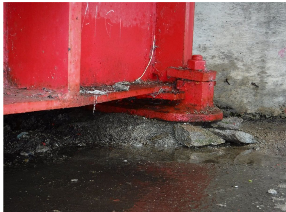
沓座モルタルが破損し傾いている
