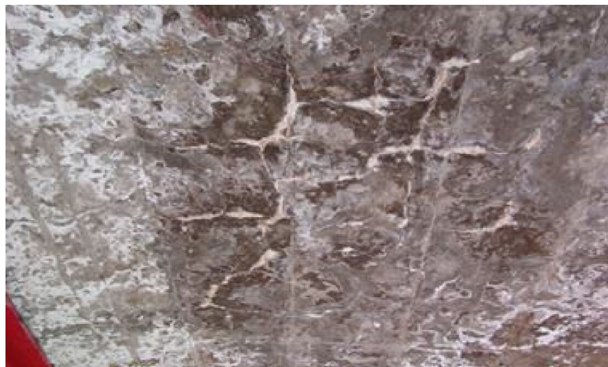
漏水を伴う格子状のひび割れ
