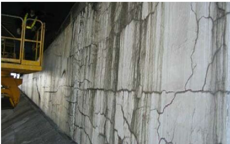
橋台豎壁前面に漏水跡と亀甲状のひび割れ
