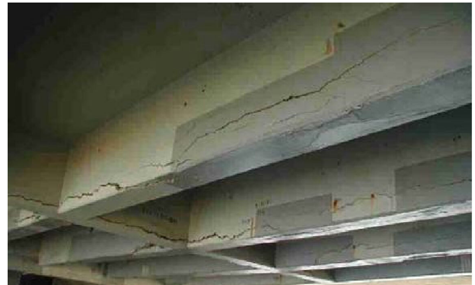
主桁に顕著なひび割れと錆汁の滲出
