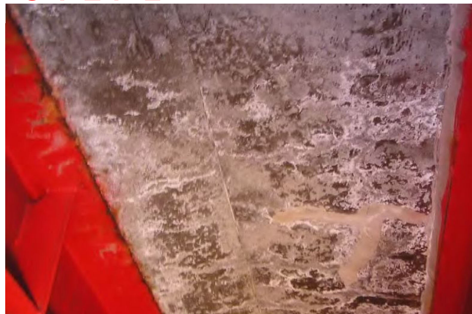
広範囲な床版のひび割れ
