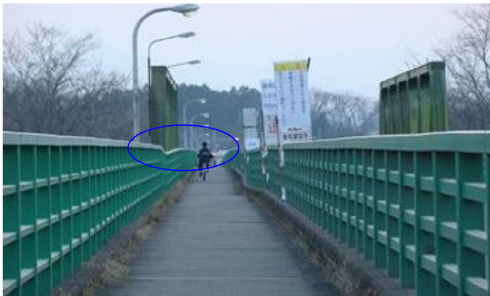
防護柵にズレがある
