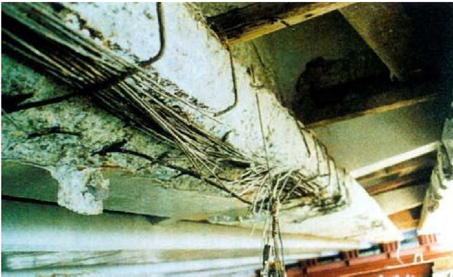
コンクリートの剥離、鉄筋・PC鋼線の露出、破断
