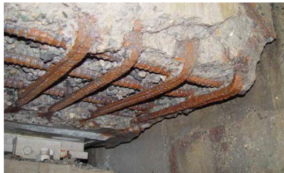
伸縮装置からの漏水による剥離・鉄筋露出
