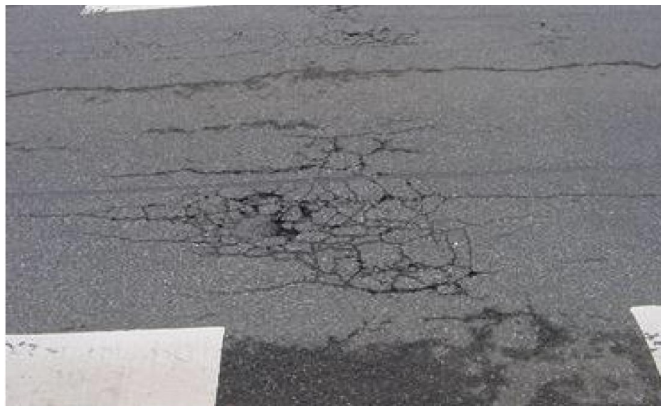
舗装のひび割れ
