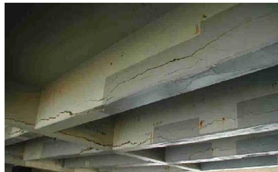
主桁に顕著なひび割れと銹汁の滲出
