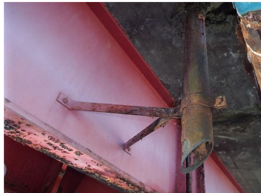
排水管の腐食
