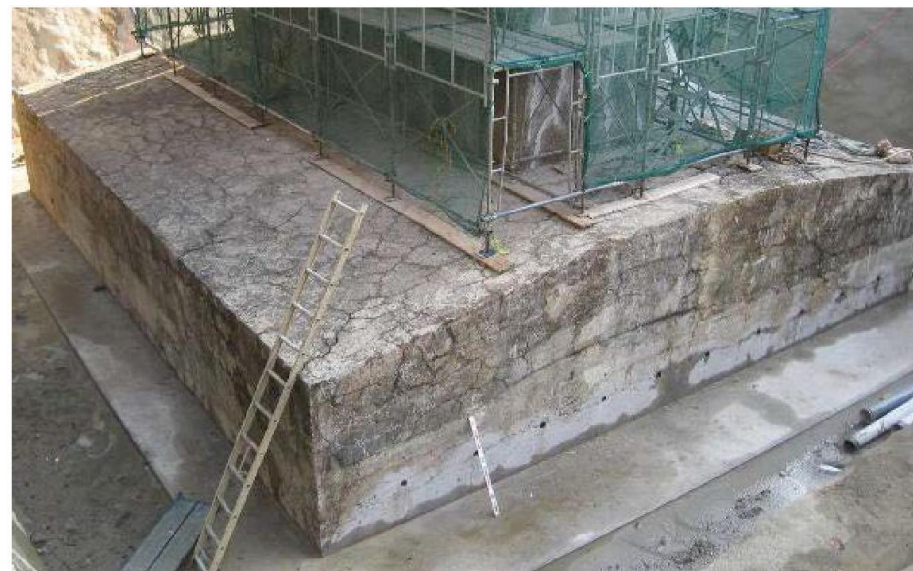
地中部にあるフーチングに亀甲状のひび割れ
