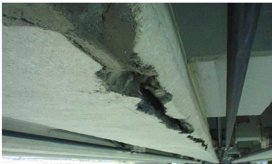
再劣化により、ひび割れ、鋼材露出
