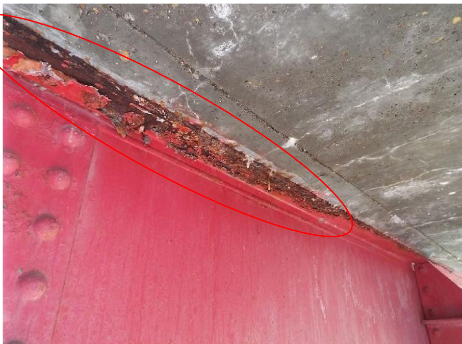
床版からの漏水による腐食
