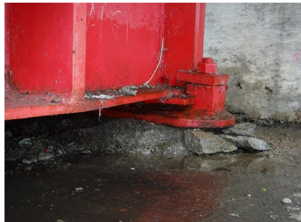
沓座モルタルが破損し傾いている
