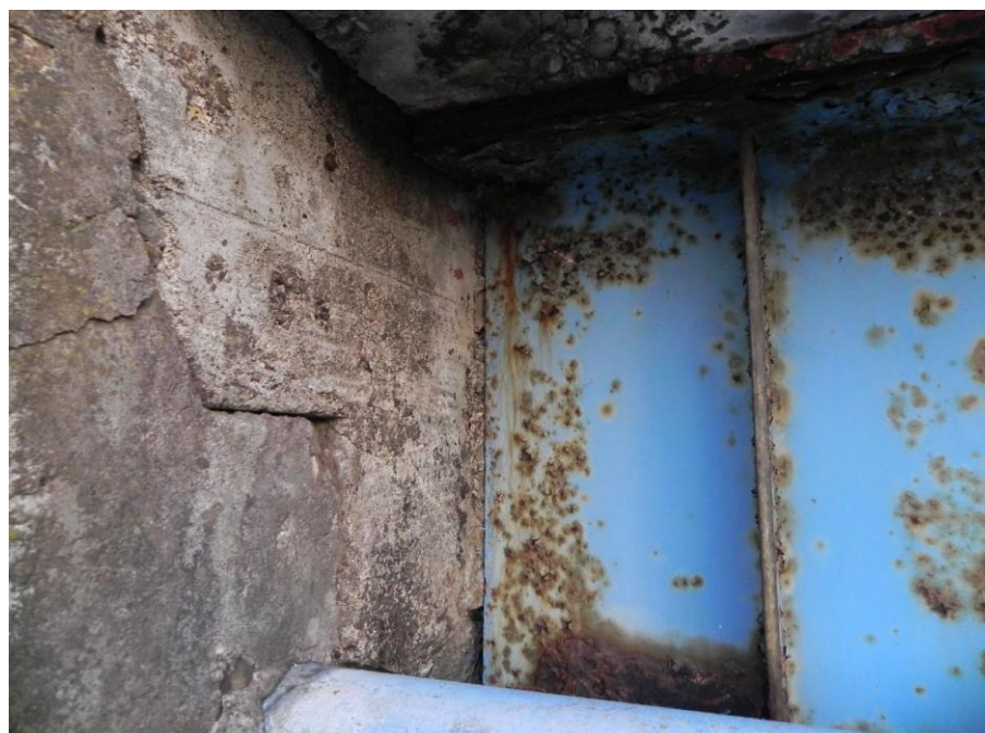
橋台と桁のぶつかり
