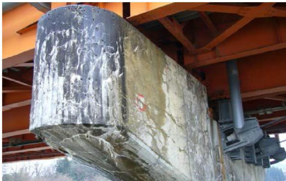
橋脚張出部に白色の滲出物を伴う亀甲状のひび割れ
