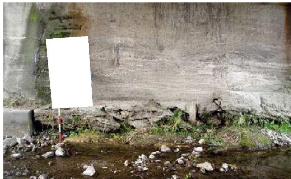
橋脚が洗堀されている
