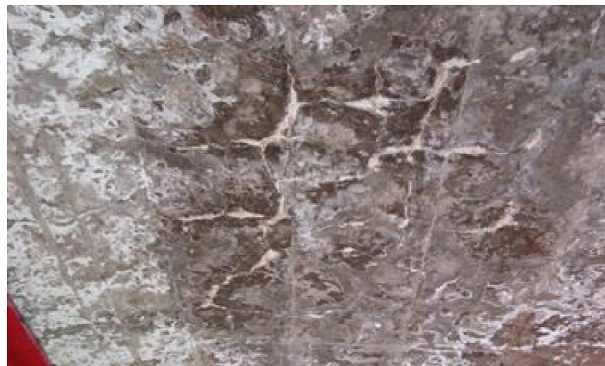
漏水を伴う格子状のひび割れ
