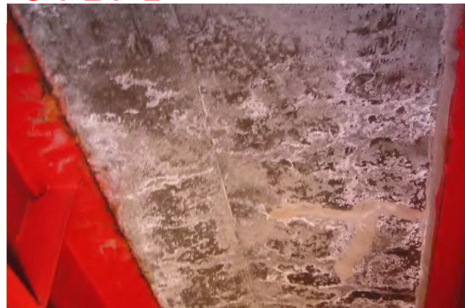
広範囲な床版のひび割れ
