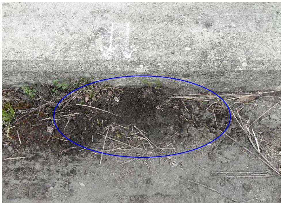
排水柵の土砂詰まり
