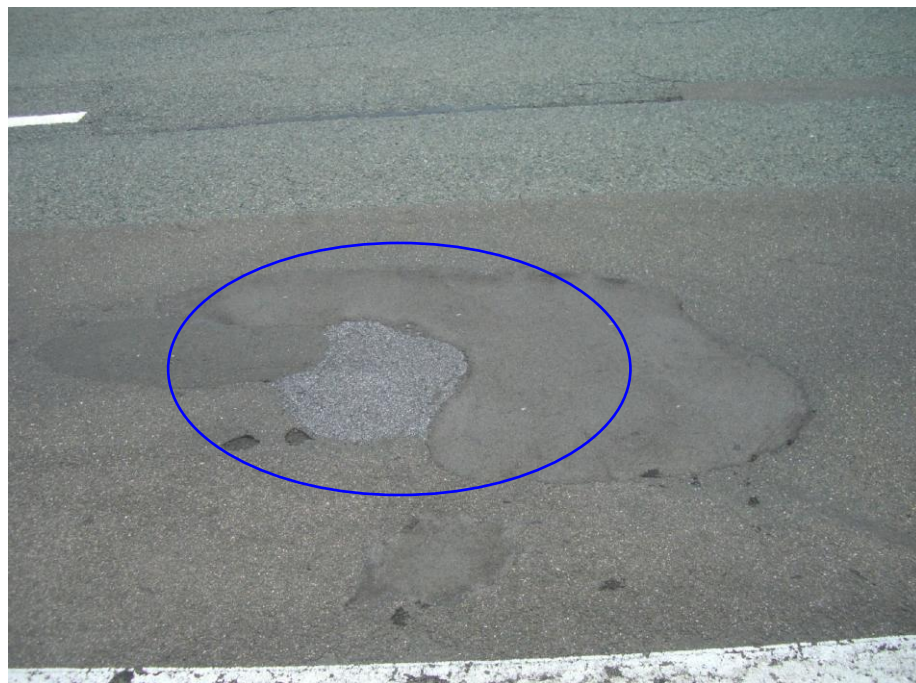
舗装にポットホール 凸凹がある
