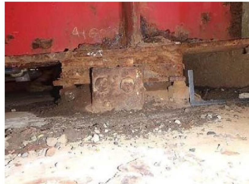
支承の著しい腐食
