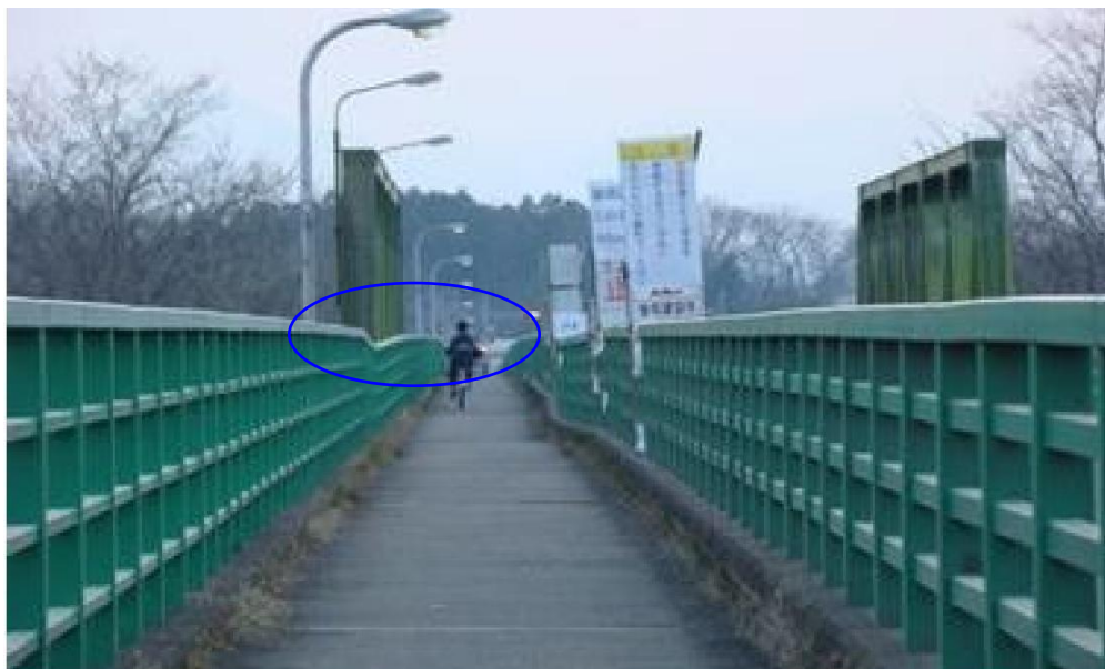
防護柵にズレがある
