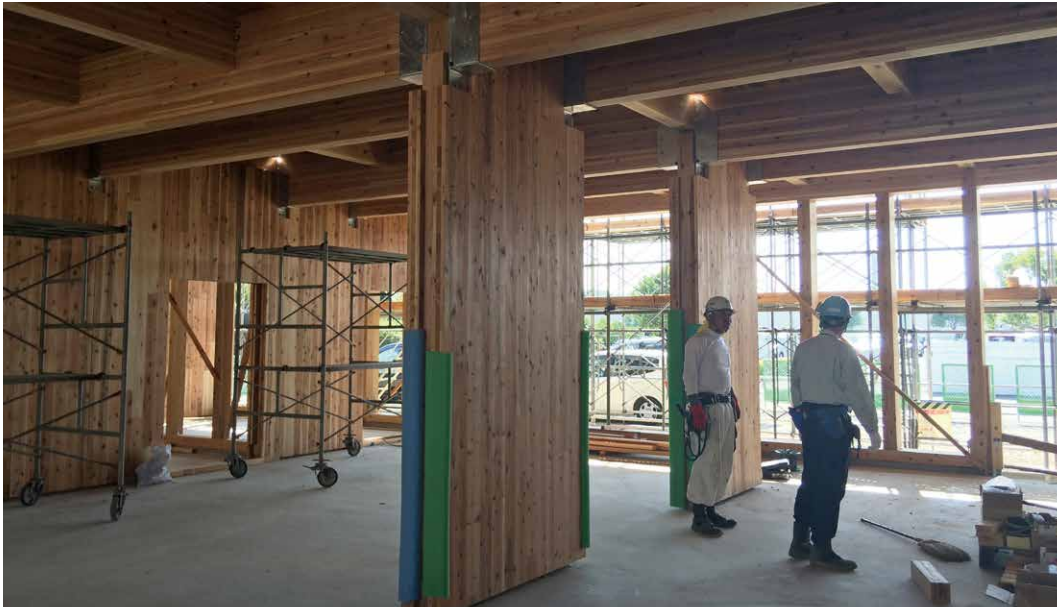
木造軸組の柱とはりにCLTを耐震壁として使用
