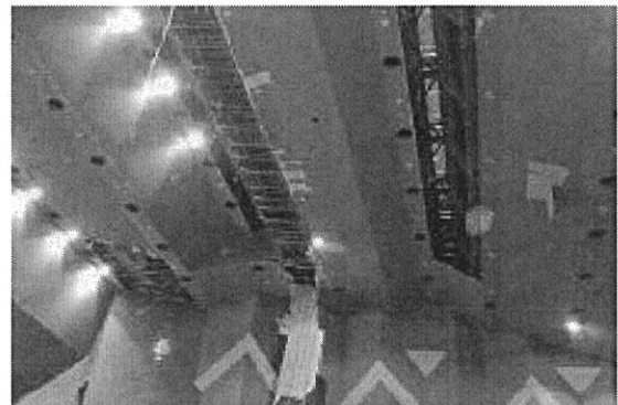
ホール(変形天井)：天井脱落、下地変形
