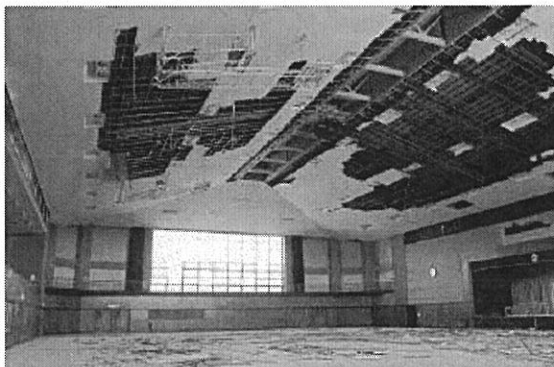
体育館：天井脱落、下地破損
