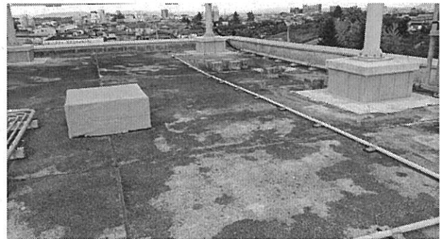
⑩平鹿地域振興局庁舎 屋根防水…雨漏り有り
