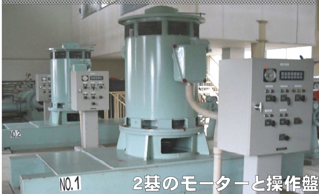
ポンプ設備（φ800mm×220kW×2台）
