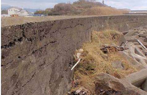
写真11 老朽化施設の例 (仁賀保海岸)
