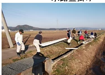
～積雪被害防止の 水路蓋掛け～
