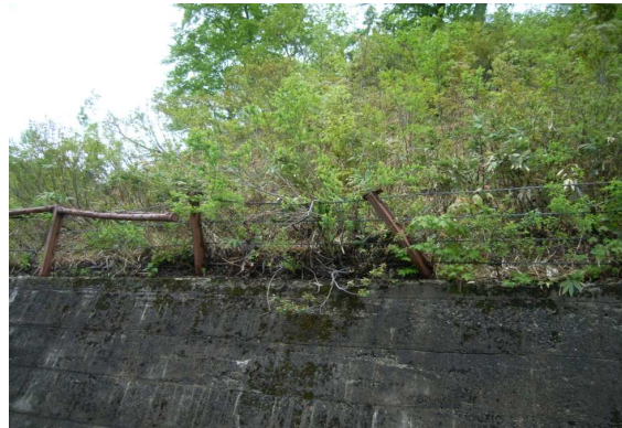
落石防護柵工 国道341号 田沢湖(仙北市)
