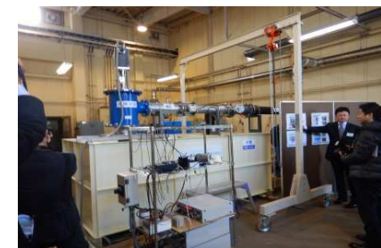
低発電コスト低落差式 小水力発電システム
