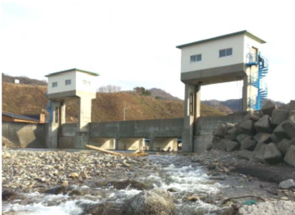
《老朽化の進んだ津波・高潮・洪水対策の水門》 （浜田・八森海岸（泊川水門） 八峰町）
