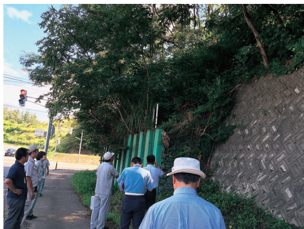
◇栄小（歩道山側の法面が危険）
