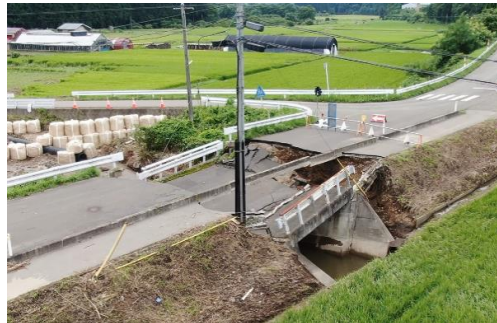
比内大葛鹿角線 道路損壊（大館市比内町 味噌内小橋）
