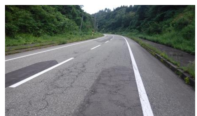
アスファルト舗装ひび割れ 国道105号(大仙市南外)
