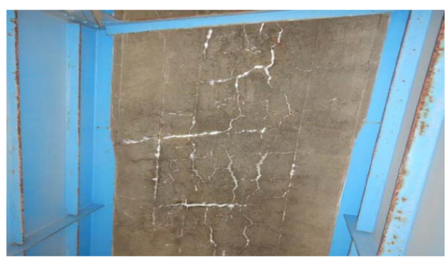
床版ひび割れ 四ツ屋神岡線(松倉橋)
