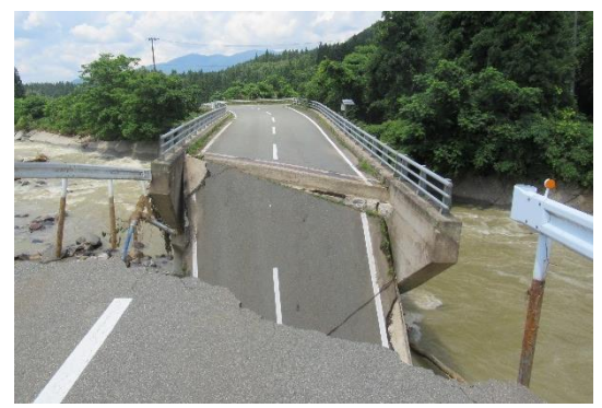
令和5年7月豪雨 岩見船岡線(秋田市河辺岩見 新川橋)
