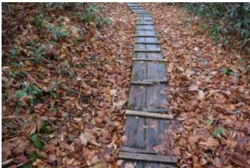
木道の老朽化の状況
