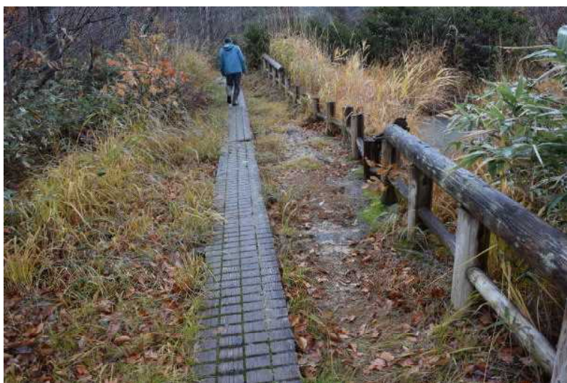
防護柵の老朽化の状況
