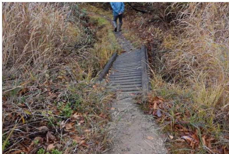
木橋が老朽化により傾いている。
