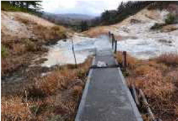
噴気孔の拡大で既存 路線が通行不能 (起点側)
