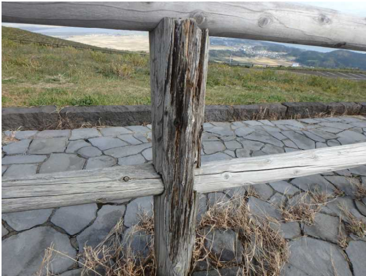
手摺支柱腐朽狀況
