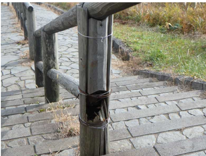
手摺支柱腐朽狀況
