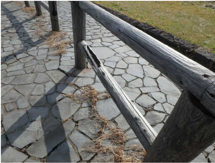
手摺腐朽状況
