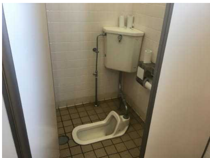
トイレ大便器
