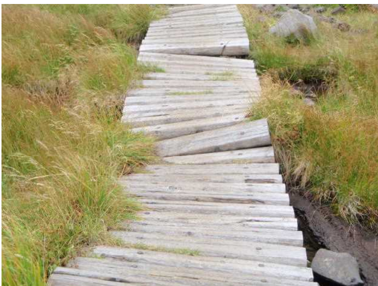
経年劣化により土台が腐食し床板が波打っている
