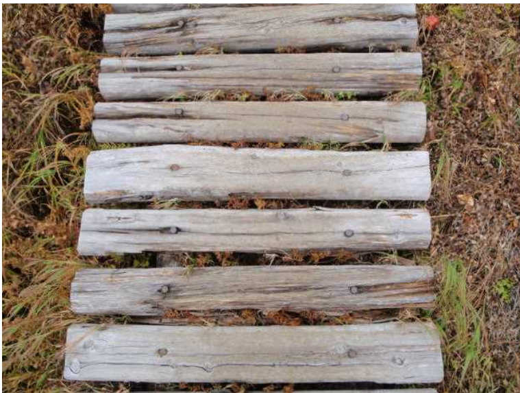
木道の劣化状況
