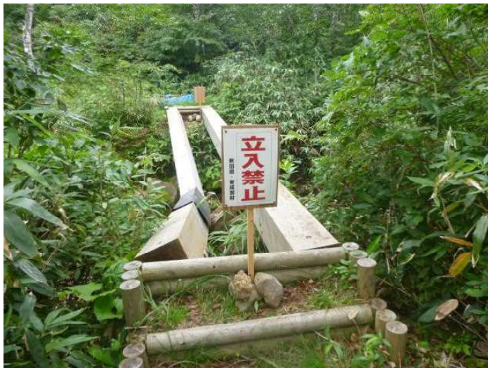
H25 豪雪による木道橋の損壊状況
