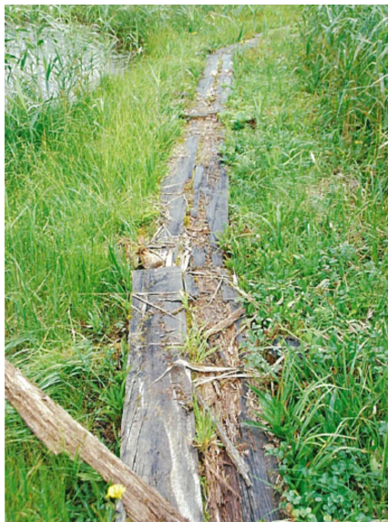
木道の腐食による損傷状況
