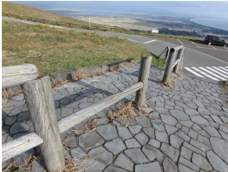
手摺腐朽状況
