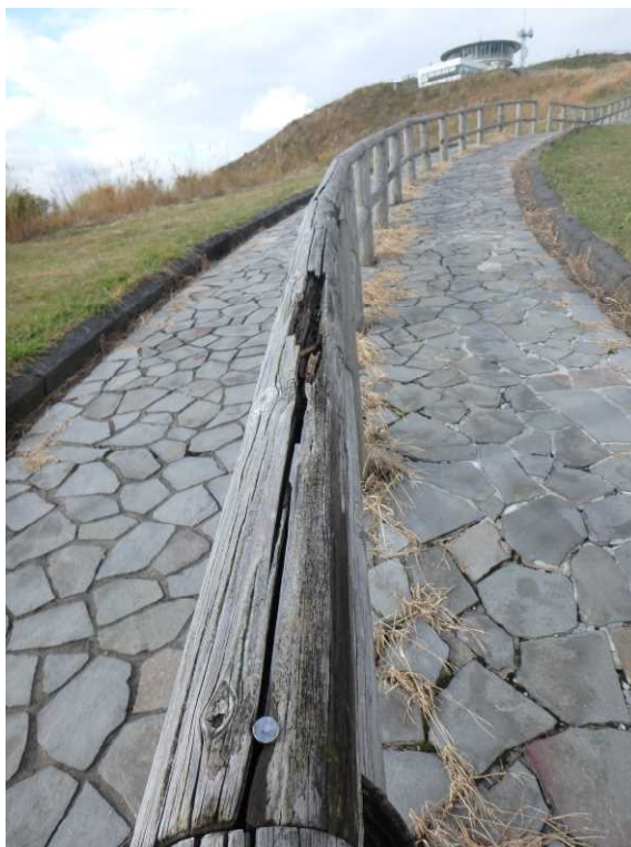
手摺腐朽状況
