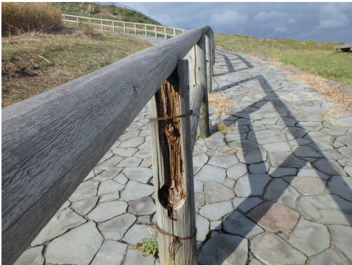
手摺支柱腐朽狀況
