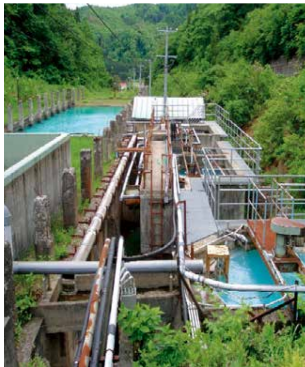
吉乃鉱山（横手市）坑廃水処理施設
