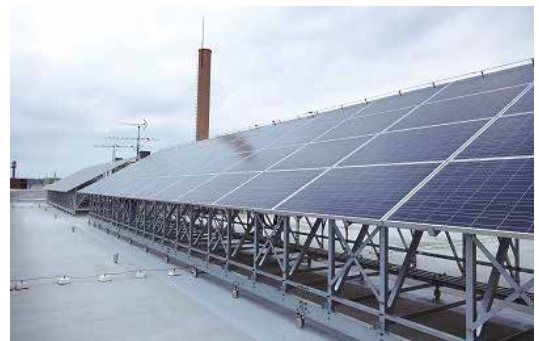
県庁舎に設置した太陽光発電設備
