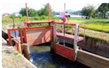
ゲートの老朽化、 担い手不足による操作の困難化
