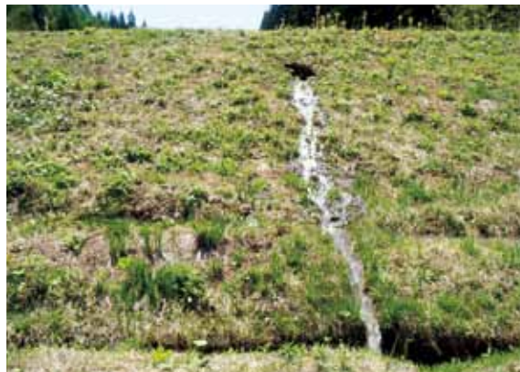
羽後町 ため池の漏水
