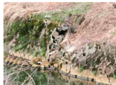
大宮川幹線排水路 積ブロック崩壊状況
