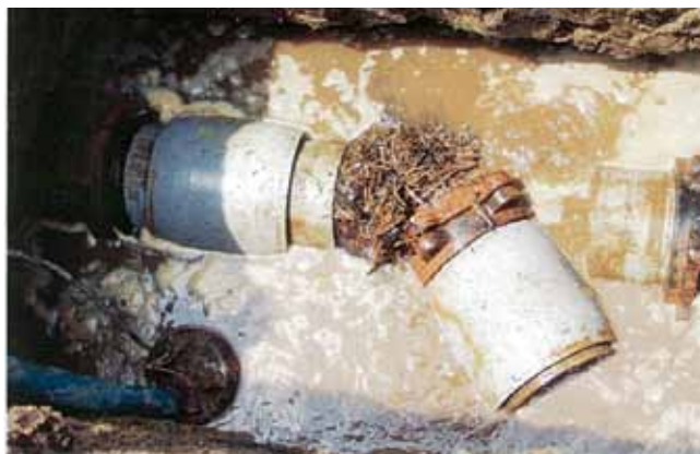
パイプラインの破損 整備前（横手市）
