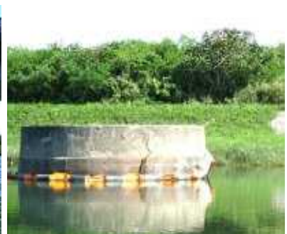
飲料水の吸水口
