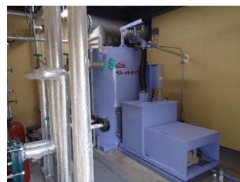
木質バイオマスボイラー
