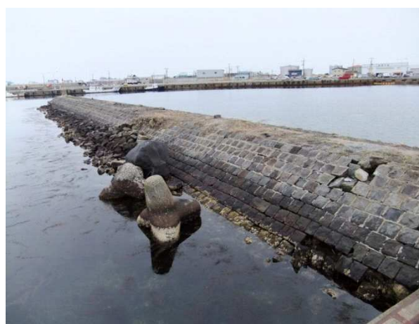
船川港 防波堤 損傷状況
