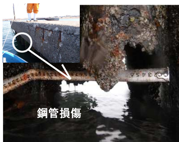
能代港 波除堤鋼管杭 損傷状況
