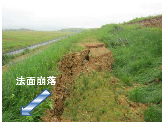
法面崩落状況写真
