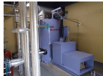
木質バイオマスボイラー
